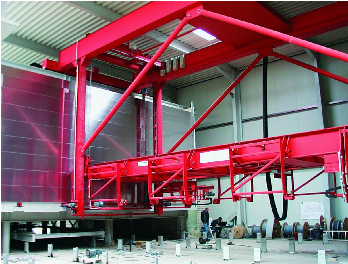
Rack feeder (overhead)
